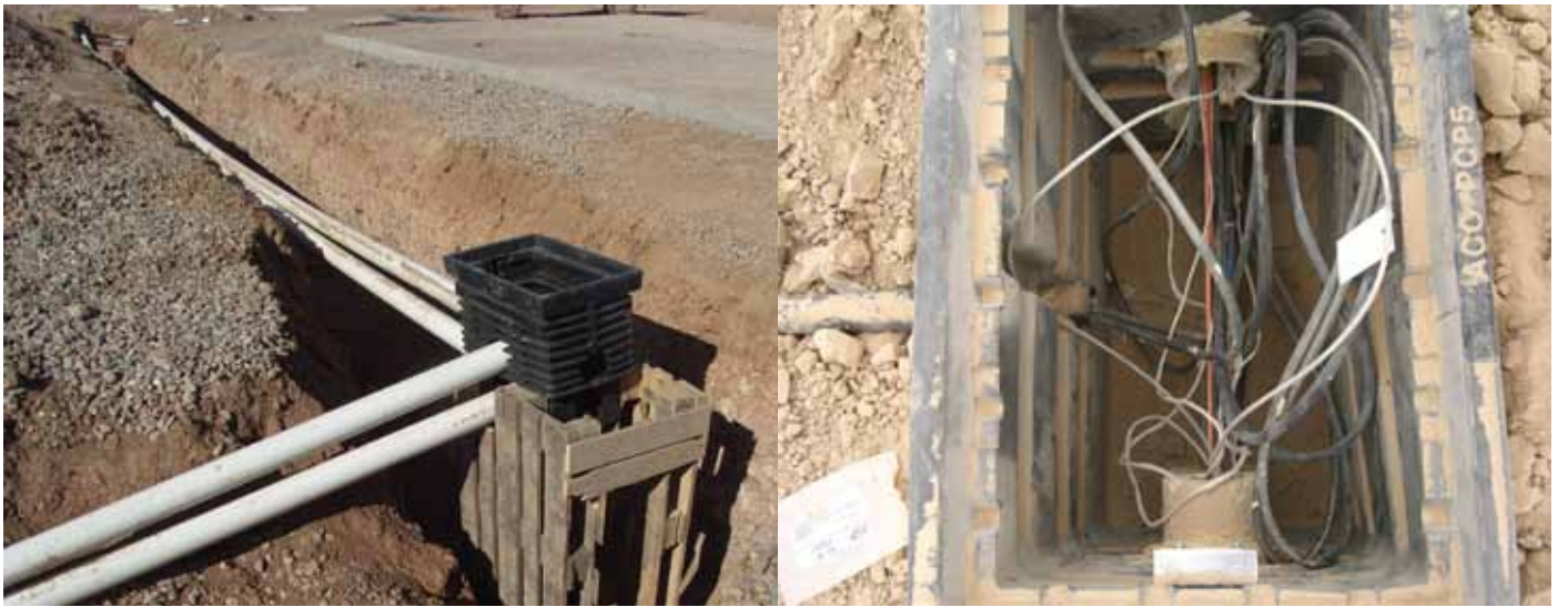
Samenwerking Genie en Verbindingsdienst. Foto toont een Pit&Duct systeem. Foto's: smi P.N. Pannekoek en sgt1 W.B. Verweer
